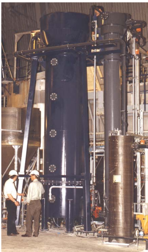
Réacteur de 30 m 3 /h en construction sur la centrale énergétique de Avedøre, Copenhague - Danemark
